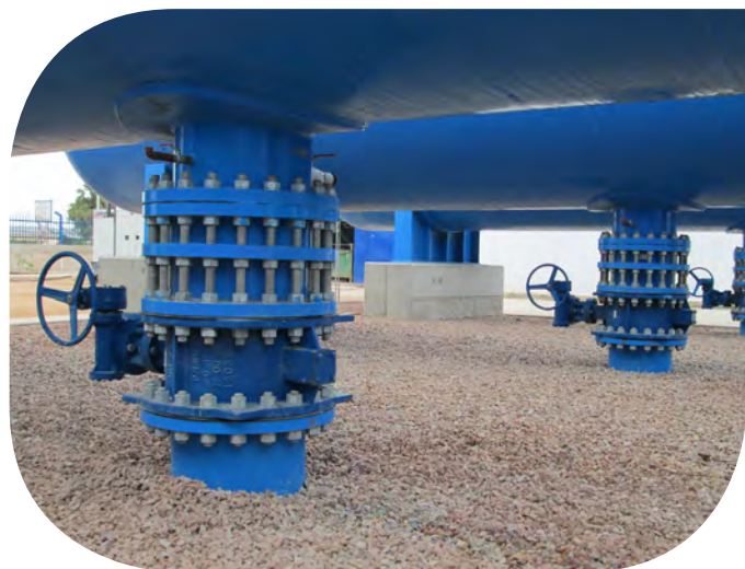
Válvulas de mariposa motorizadas - CORSÁN CORVIAM (Argelia)
