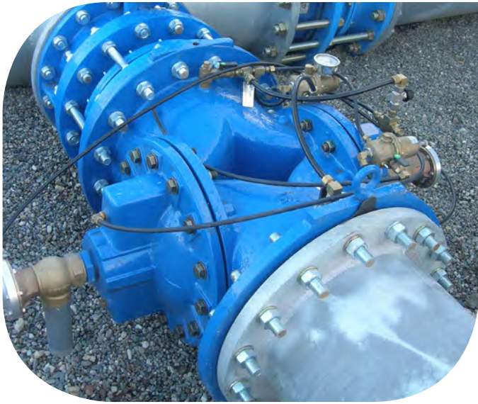
Válvula hidráulica reductora de presión - TRAGSA (Málaga)
