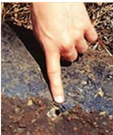
Perforación típica de una canalización con insuficiente protección contra las corrientes de dispersión.
