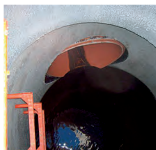
FALTA DE ESTANQUEIDAD EN POZOS DE HORMIGÓN.
