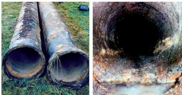
TUBERÍAS QUE HAN SUFRIDO ATAQUES POR CORROSIÓN ELECTROQUÍMICA.
