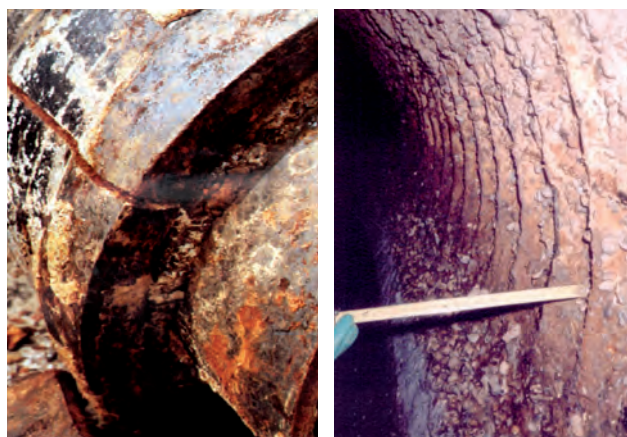
EFFECTOS DE LA CORROSIÓN EXTERIOR E INTERIOR EN TUBERÍAS.
