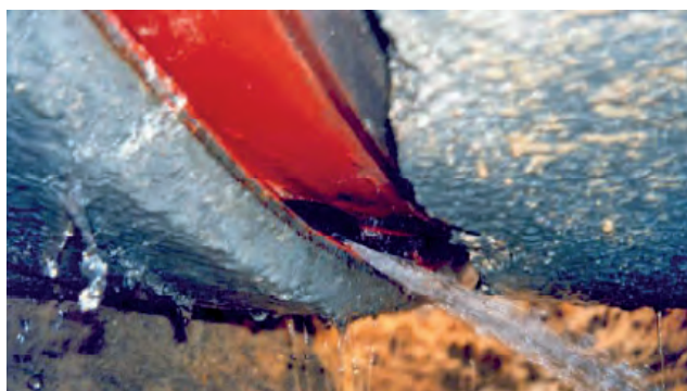
FUGA POR LA UNIÓN EN TUBERÍA DE HORMIGÓN.
