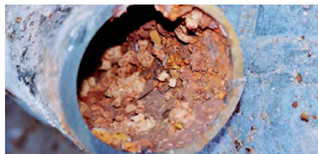
TUBERÍA DE SANEAMIENTO CON DEPOSICIONES DE MATERIAL.
